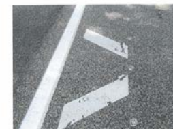
Slika 7: Več poškodovanih zaporednih tleh označbah
